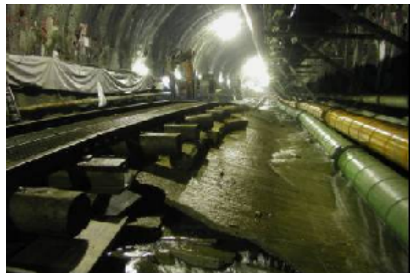
写真-2 本坑接近後の盤膨れ
