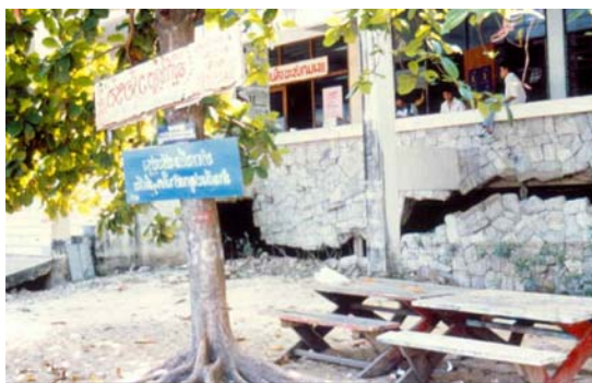
(c) 住宅の被害
