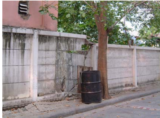
(b) 民家の壁のせん断クラック
